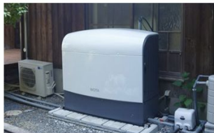
▲ 循環システム設置場所 愛媛県 今治市
